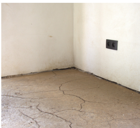
Surface fissurée de la chape
