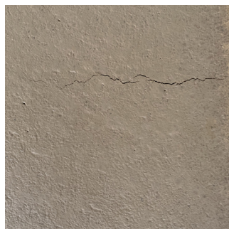
Chape molle: surface brillante Les fissures commencent à se former
