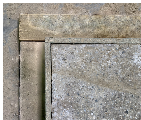
Exemple de retrait sur les bords d'un coffrage
