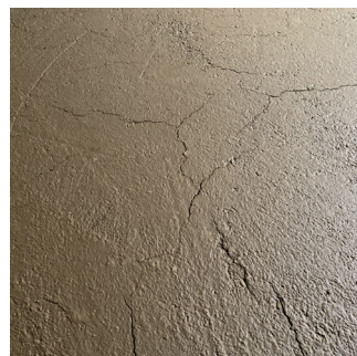
Chape ferme au toucher : surface mat
